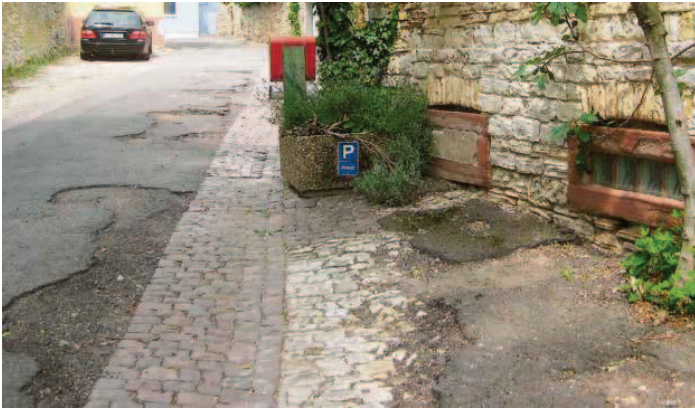
Vorher: Wirklich in einem sehr sanierungsbedürftigen Zustand präsentierten sich einige Sträßchen vor der Sanierung im Ortskern von Dalsheim.
